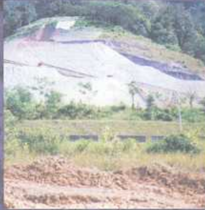
Cerun runtuh dibaik pulih menggunakan timbunan batu-batu menutup bahagian yang telah runtuh dan mengekalkan kestabilan
