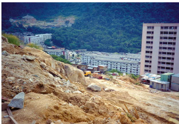
Gambarfoto 4.1 : Pembangunan Lereng Bukit Yang Tidak Terkawal Photo 4.1 : Uncontrolled Hill Slope Development
