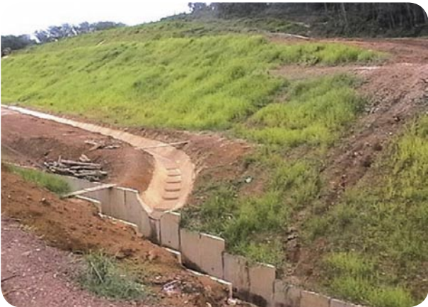
Gambarfoto 4.3 JAS: Sistem Perparitan untuk Mencegah Hakisan Kawasan Cerun Photo 4.3 DOE : Drainage System for Slope Protection
