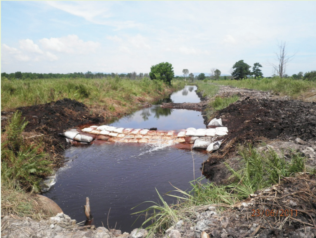
Sekatan saluran baru menggunakan rekabentuk guni pasir di kawasan pengairan IADA di Bachok Kelantan / New gunny sack designed check dam at IADA irrigation scheme area in Bachok, Kelantan
