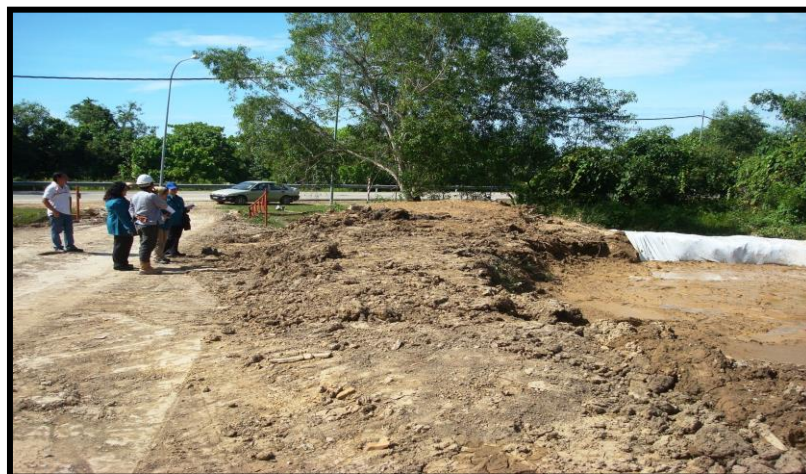
Penyelenggaraan silt trap yang tidak sempurna
