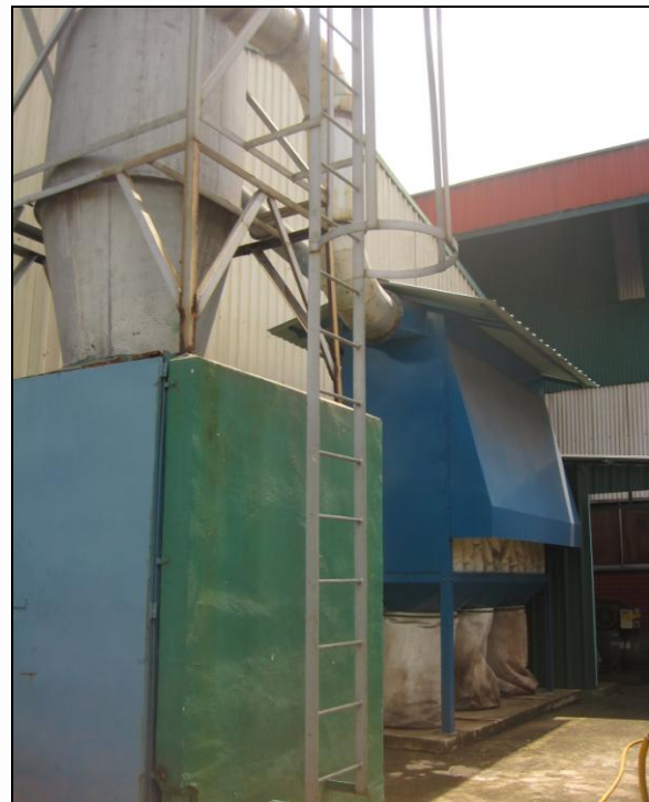
Plat 3.7 : Bag Filter Dust Collector yang dipasang oleh kilang bagi mengawal pelepasan habuk yang dihasilkan
