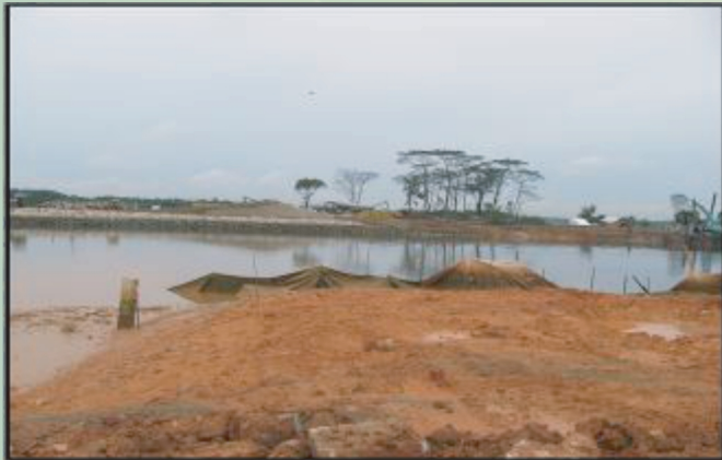
Plat 3.3: Silt fence yang tidak dipasang dengan baik
