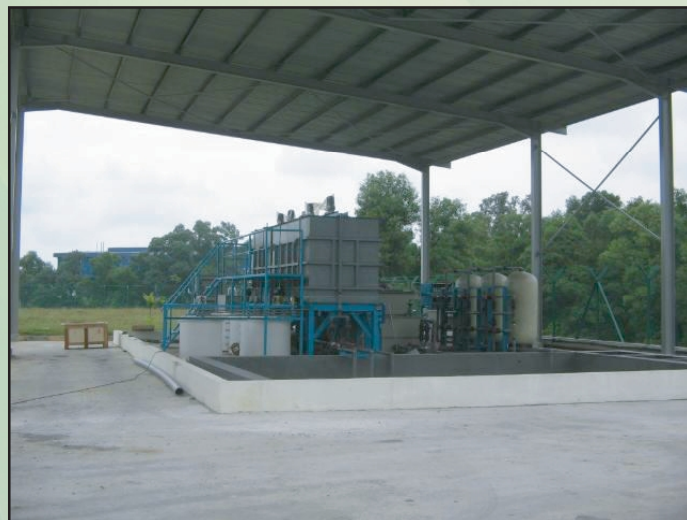
Plat 4.2 : Sistem Pengolahan Effluen Perlu Sentiasa Dipantau Dan Diselenggara Oleh Operator Yang Kompeten Bagi Memastikannya Sentiasa Berfungsi Dengan Baik.
