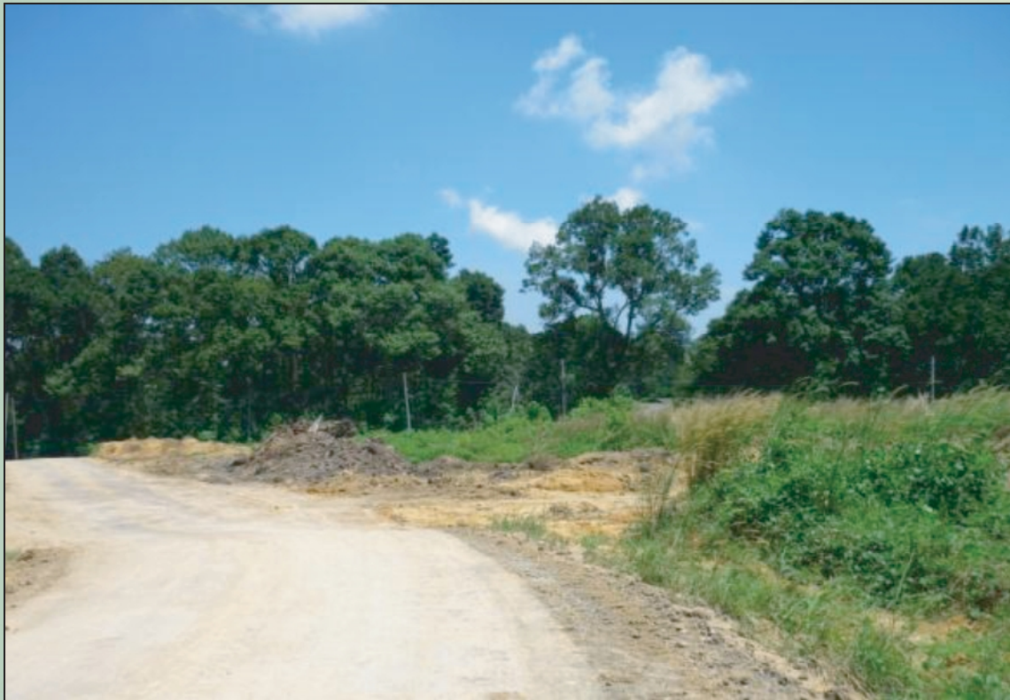
Plat 3.9 : Laluan Masuk Ke Lokasi Pembinaan Kilang Semasa Lawatan Tapak Dijalankan Bagi Menilai Kesesuaian Tapak Cadangan
