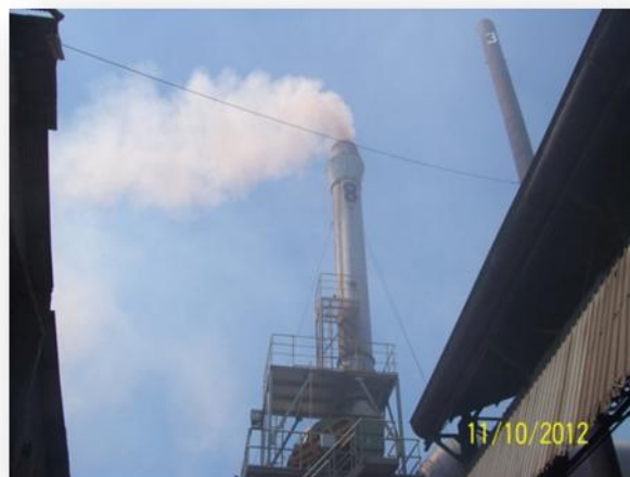
Gambarfoto 5.11: Asap perang dialirkan sepenuhnya ke cerobong scrubber
