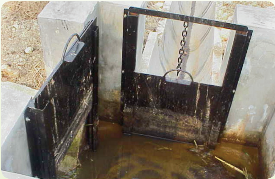
Foto 3: Sistem pengasingan pepejal ( Sedimentation Pit )
