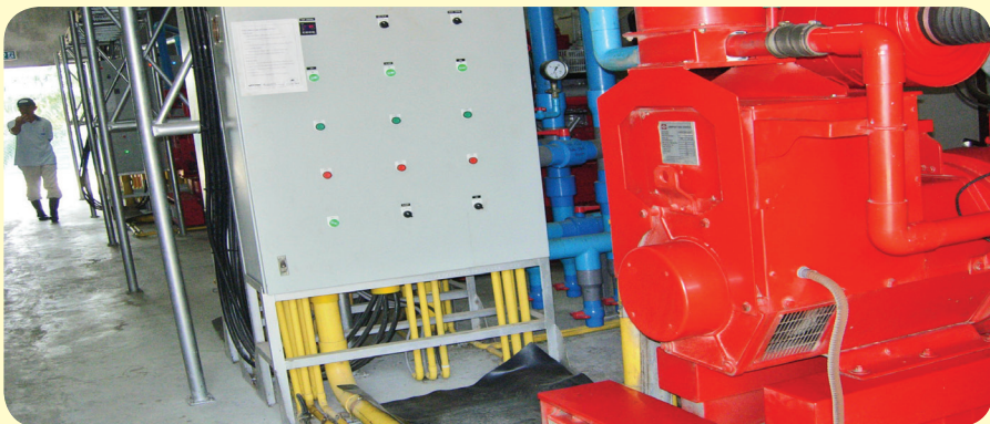
Janakuasa ( Generator ) Yang Menghasilkan Tenaga Elektrik Daripada Biogas
