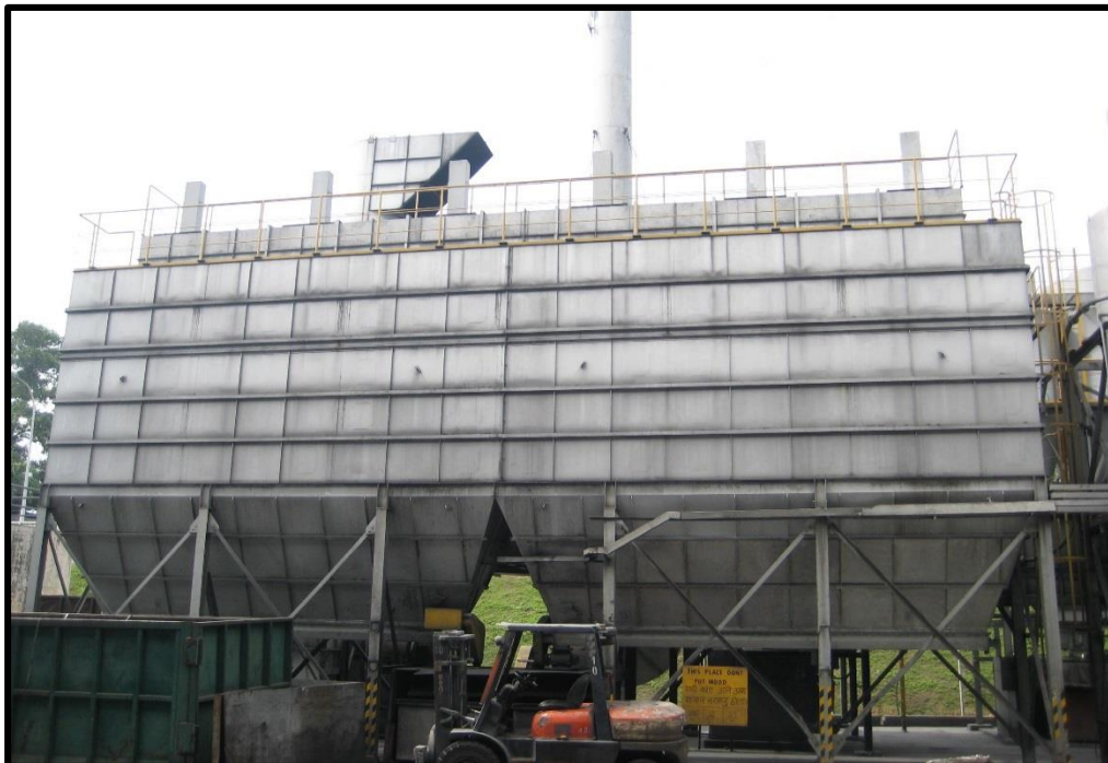
Gambar 3.3 : Pemeriksaan bagi Alat Kawalan Udara – Bag Filter
