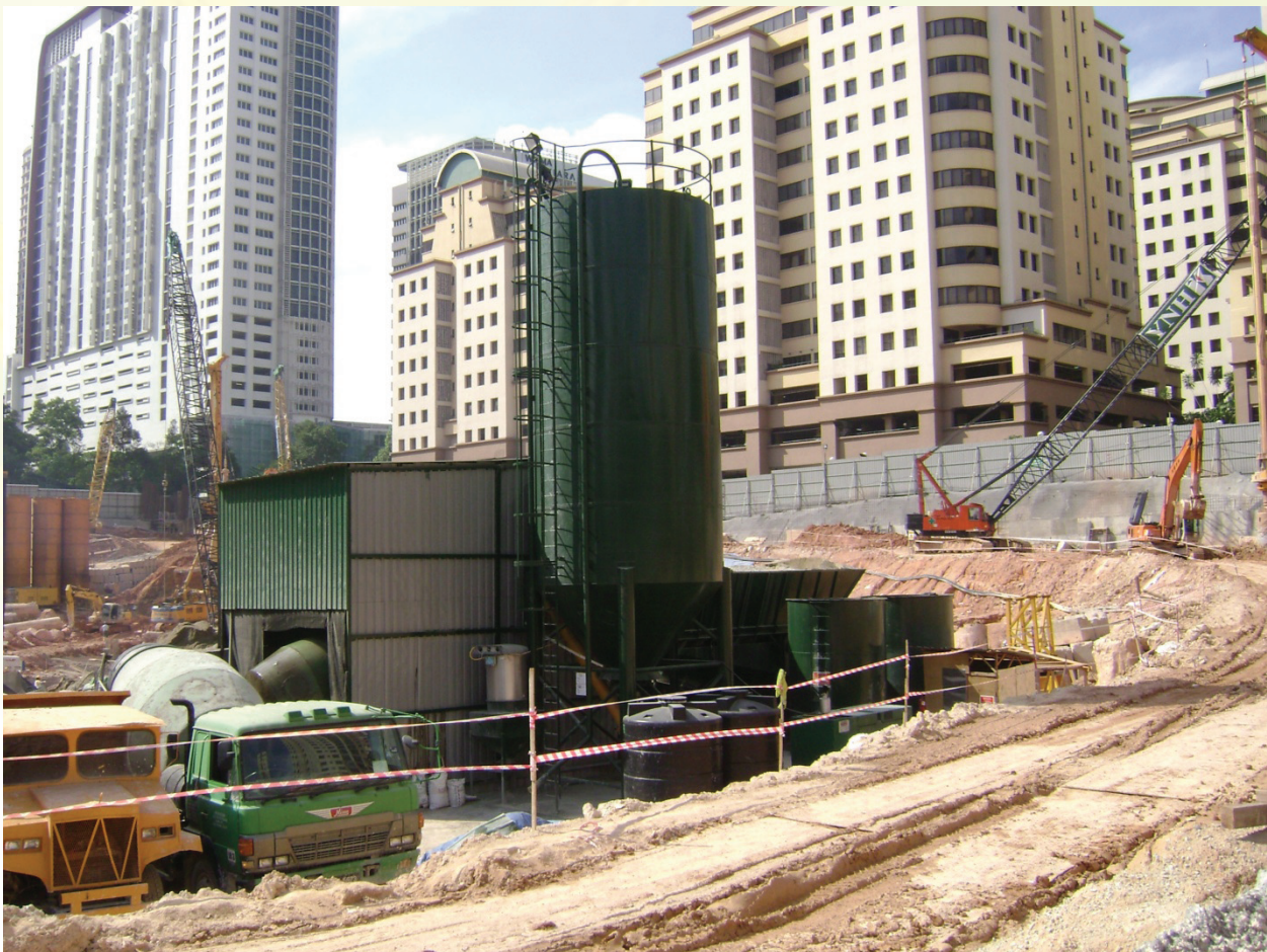
Gambar 3(f): Lawatan Tapak bagi permohonan pembinaan loji pembancuh konkrit sementara di D' Kiara
