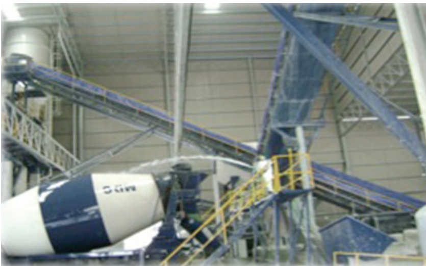
Loji Pembancuh Konkrit di (Jalan Dua) Chan Sow Lin
