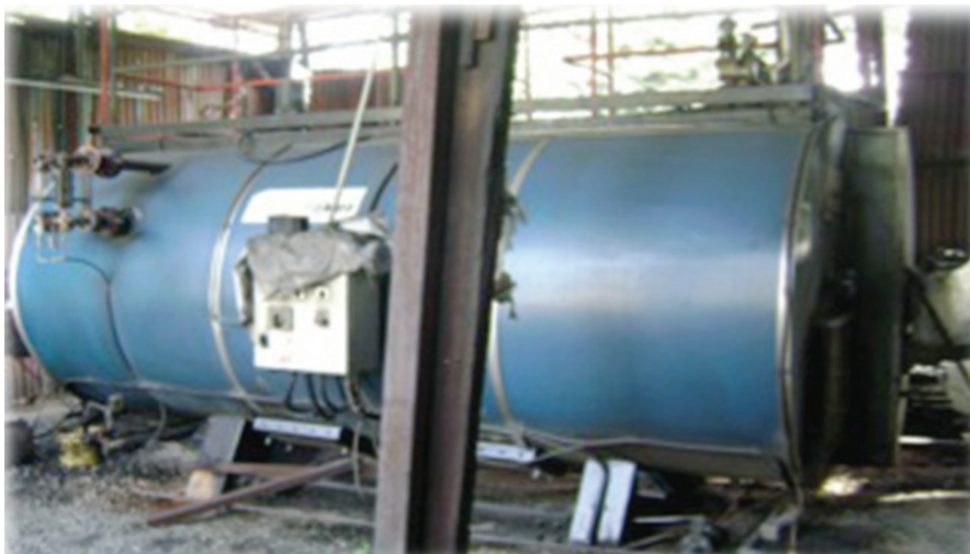
Boiler di Kilang Bihun semasa lawatan tapak
