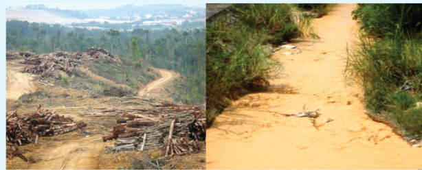
Hakisan Tanah Dari Aktiviti Kerja Tanah Yang Tidak Terkawal Soil Erosion Due To Uncontrolled Land Use Activity
