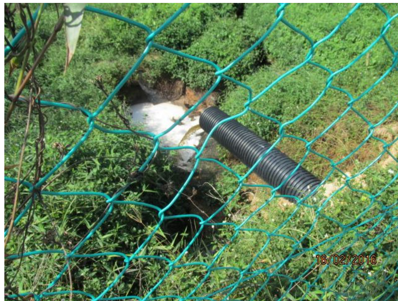
PELEPASAN LEACHATE, TAPAK PELUPUSAN SAMPAH LADANG CEP RENGAM
