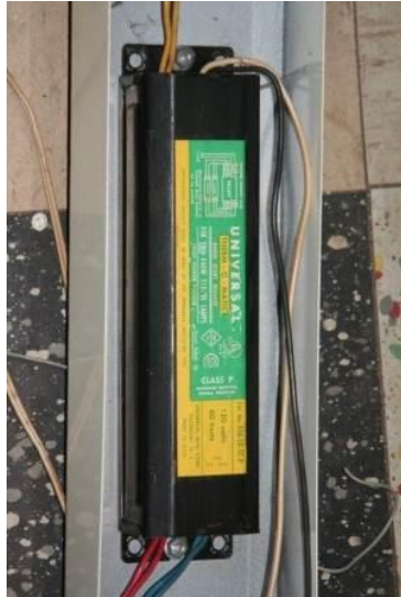
Balast lampu fluorescent lama terpakai (bahan yang mengandungi BFT)
