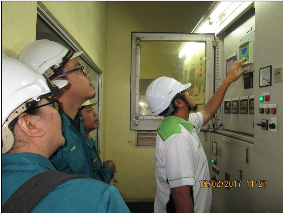
Pegawai JAS menjalankan pemeriksaan bacaan smoke density meter di Boiler Room
