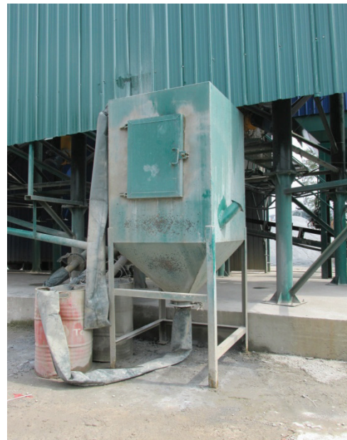
Gambar 3(k) : Alat Kawalan Pencemaran Udara Dust Collector di premis sementara loji pembancuh konkrit
