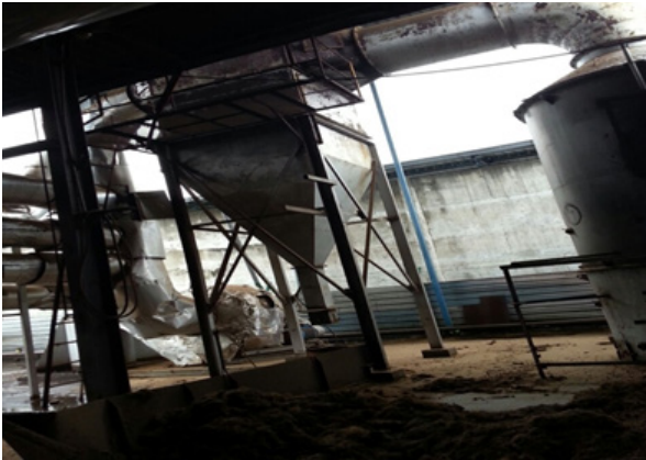
Alat kawalan pencemaran udara tidak diselenggara dan keadaan persekitaran kilang berhabuk
