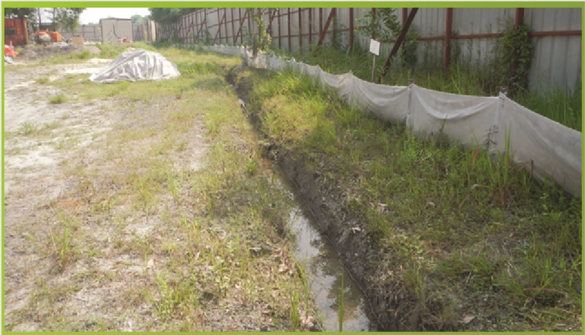
Gambarfoto 7.5 : Gambar menunjukkan “Earth Drain” di tapak projek bagi mengawal air larian permukaan
