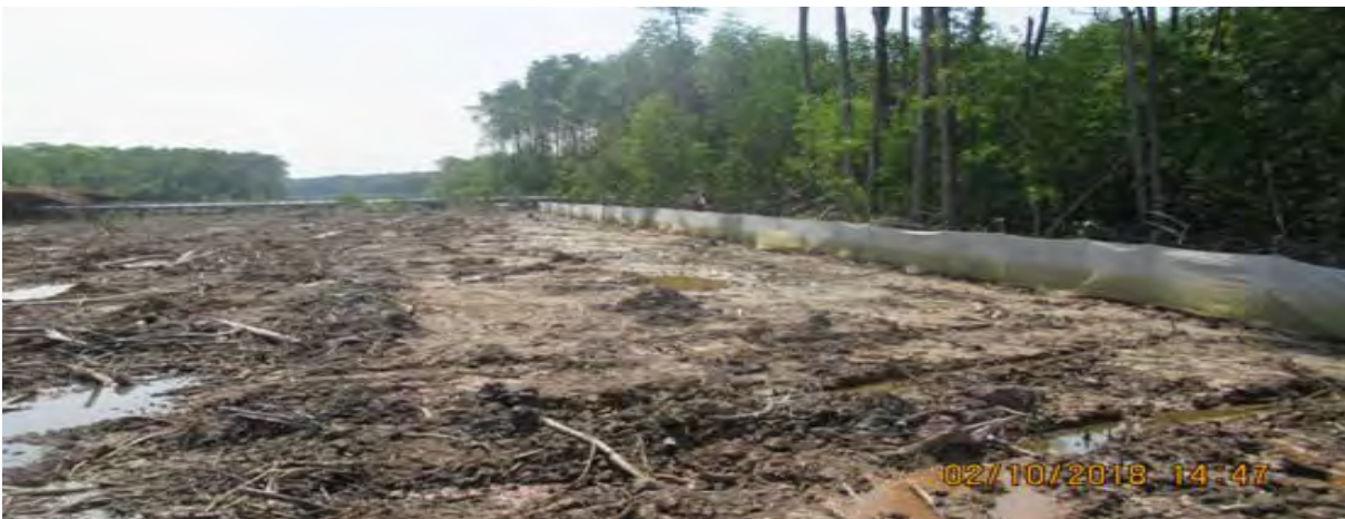
Gambar 3.3 Gelang Patah, Johor: 'Silt Fence' dipasang bagi mengelakkan kelodakan di dalam tapak mengalir keluar dari sempadan projek.
