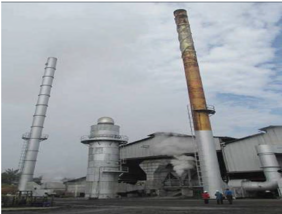
Gambar 9.7 : Pemeriksaan pemasangan baru Alat Pembakaran Bahanapi serta Sistem Kawalan Pencemaran Udara di kilang kelapa sawit
