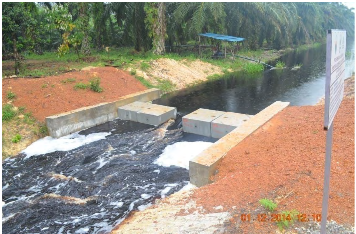
Gambar 4.11 JAS Negeri Johor : Check Dam Konkrit
