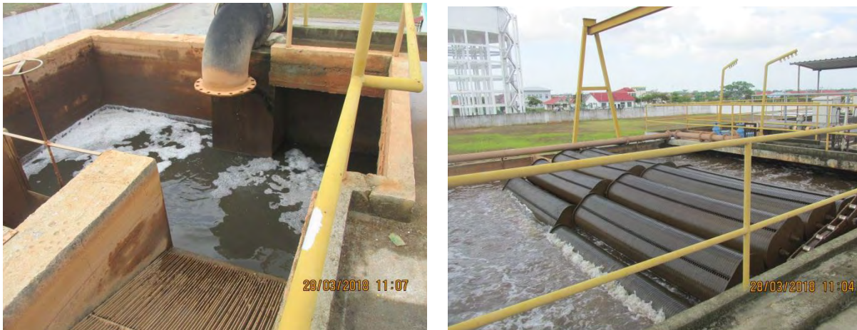
Gambar 9.14 : Keadaan loji pengolahan kumbahan yang diselenggara dengan baik
