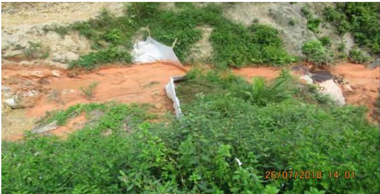
Gambar 3.6 Kota Tinggi, Johor: Contoh pemasangan BMPs yang salah sehingga mengakibatkan aliran sedimen yang tidak terkawal mengalir keluar dari sempadan projek.
