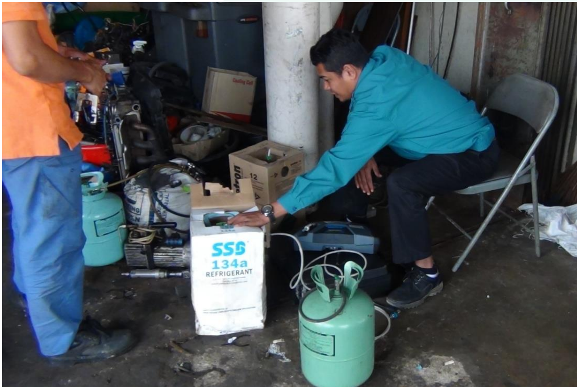
Gambar 2.2.3 Kelantan : Menunjukkan pemeriksaan Bahan Refrigerant (RI) sedang dilakukan
