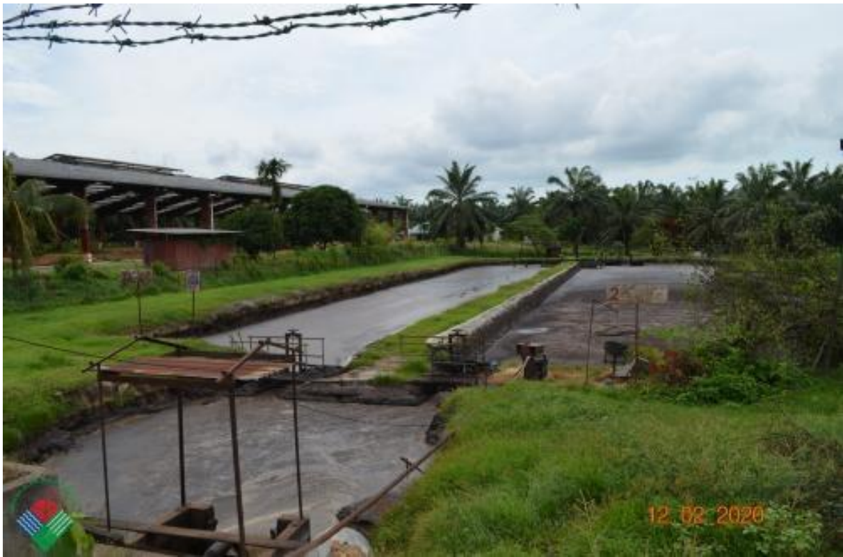
Gambar 5 : Kolam-kolam (system) Pengolahan Palm Oil Mill Effluent (POME) bagi KKS TM
