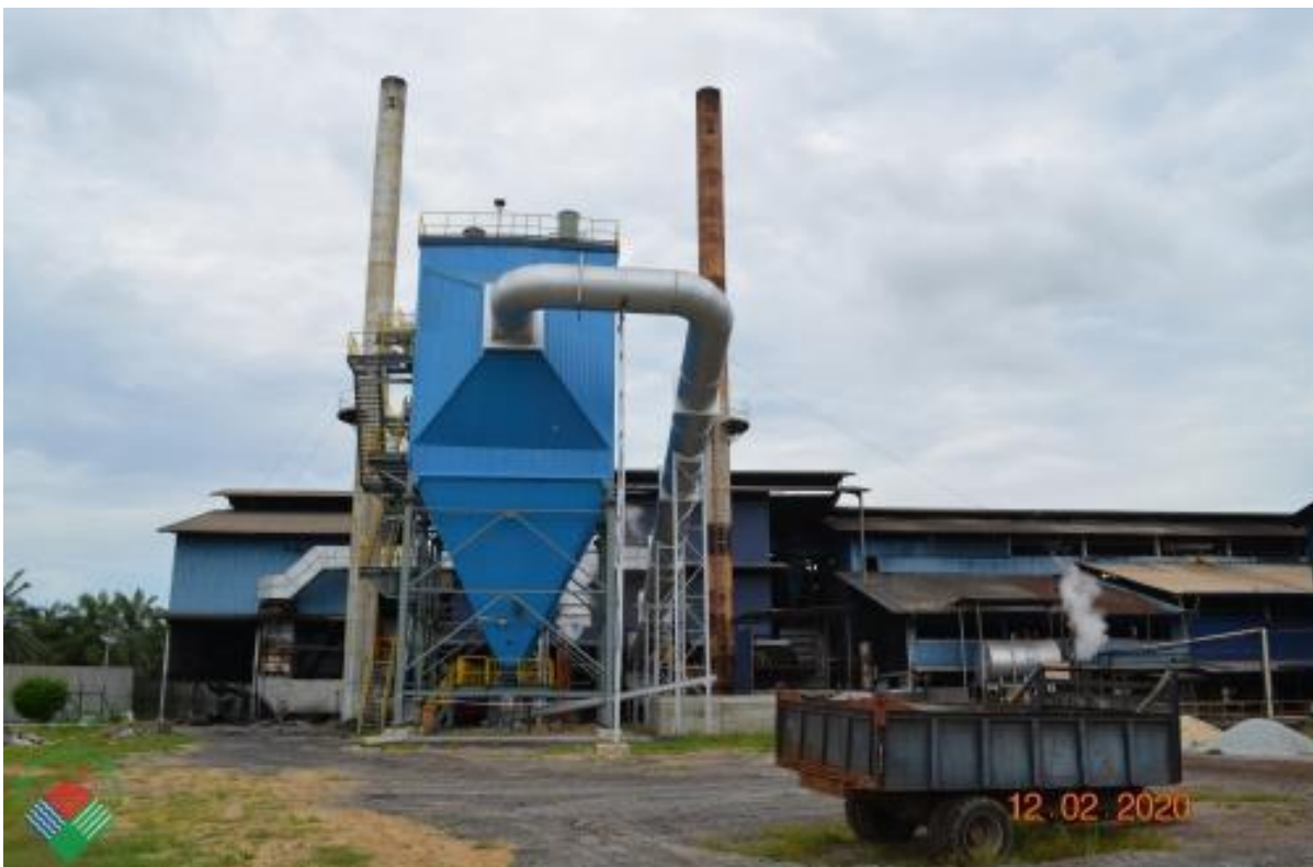
Gambar 4 : Sistem Kawalan Pencemaran Udara iaitu Electrostatic Precipitators (ESP) yang telah dipasang oleh pihak kilang
