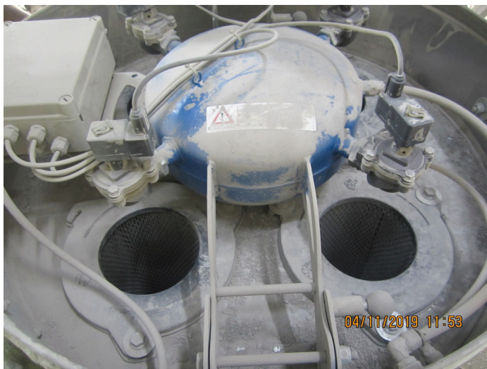
Sistem Kawalan Pencemaran Udara (SKPU iaitu Beg Penapis) yang dipasang di Loji Pembancuh Konkrit Sementara
