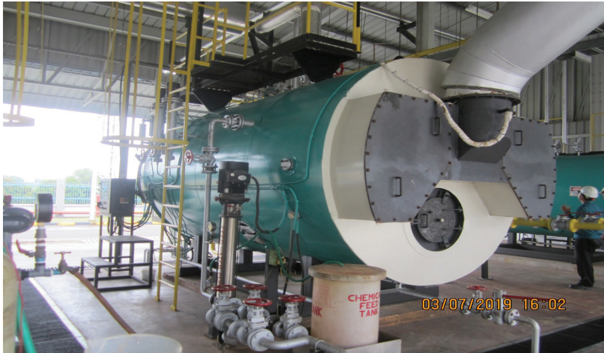
Alat Pembakaran Bahanapi - Dandang Air
