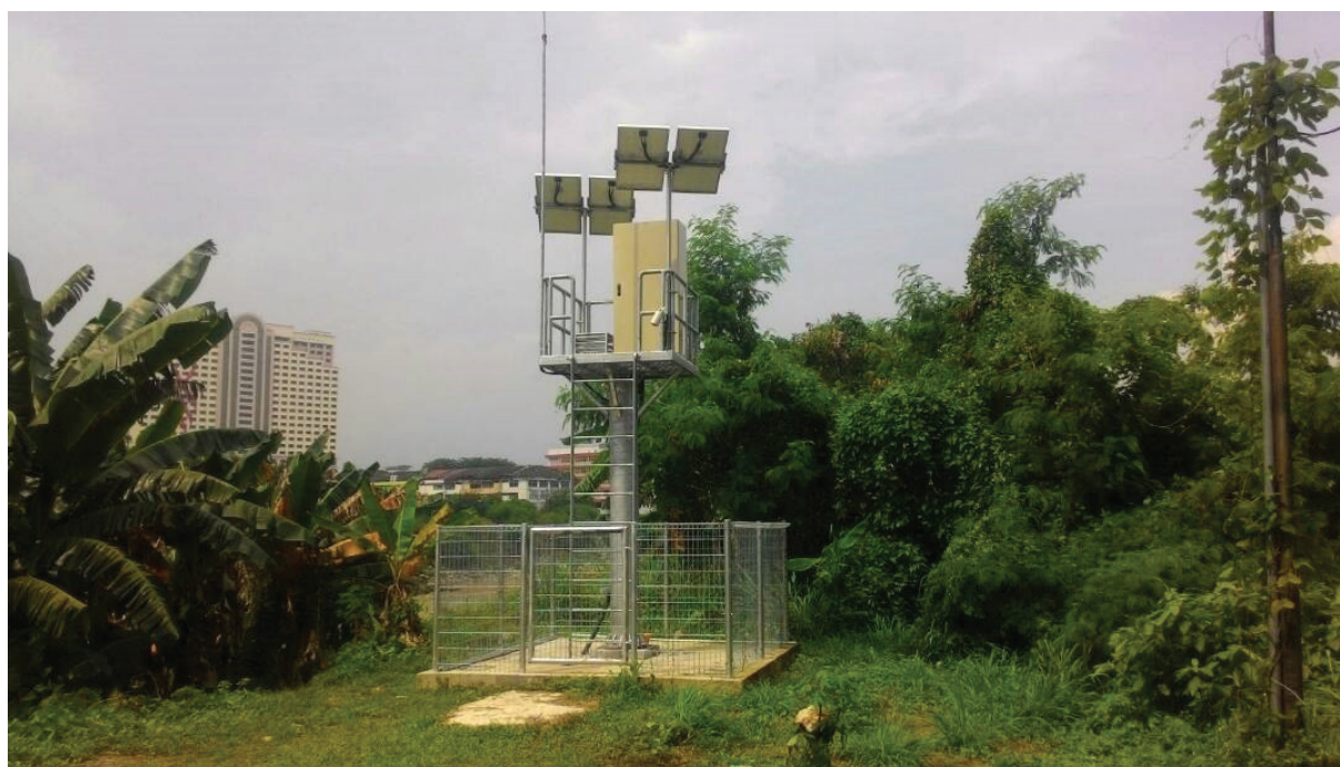
Stesen Pengawasan Air Sungai Automatik (CWRQM) seliaan JAS WPKL, 2019
