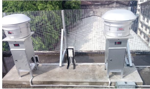
Stesen Udara Manual di Wisma SCA, Wilayah Persekutuan Kuala Lumpur
