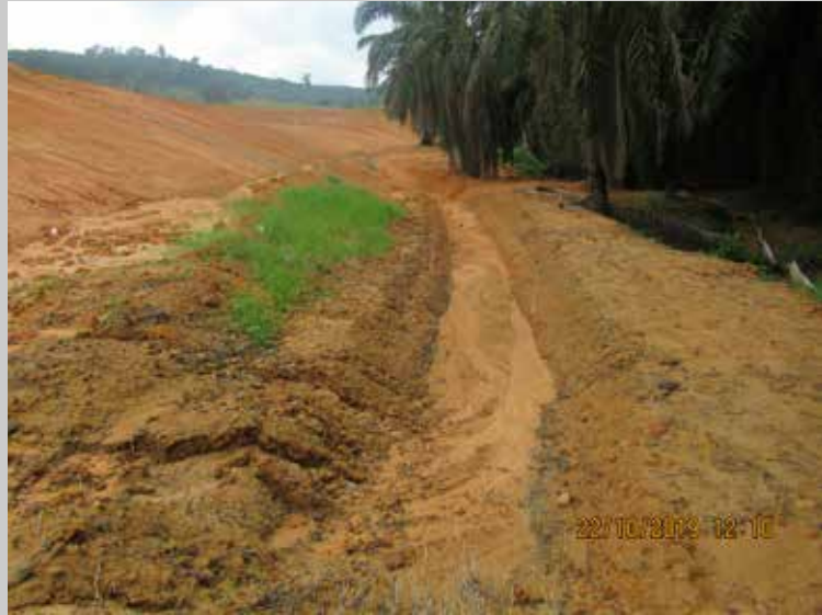
Gambar 3.15 : Tebing yang terdedah dan tiada turfing dijalankan membuatkan tanah terhakis dan membawa lumpur yang menyebabkan kegagalan BMPs di Batu Pahat, Johor
