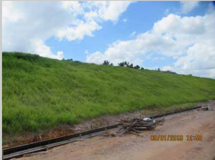
Gambar 3.5 : Landasan Kereta Api Berkembar, Segamat: Penanaman rumput di tebing yang terdedah bagi mengelakkan hakisan
