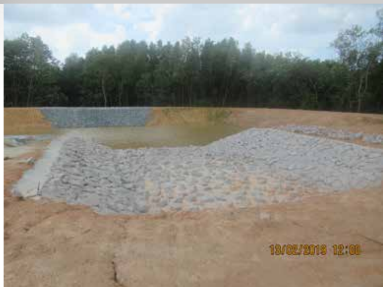
Gambar 3.6 : Kolam perangkap mendap yang dilengkapi dengan inlet dan outlet yang baik di Nusajaya, Johor
