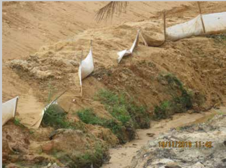
Gambar 3.11 : Pemasangan silt fence di lokasi yang salah mengakibatkan kegagalan fungsi alat kawalan hakisan dan kelodakan di Kluang, Johor
