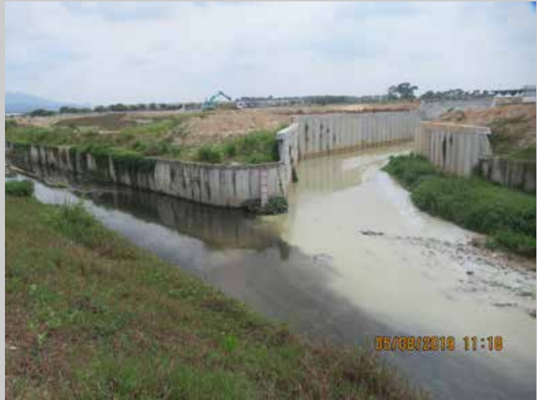
Gambar 3.13 : Kegagalan memasang alat kawalan untuk mengawal air larian permukaan menyebabkan pencemaran pada anak sungai di Kangkar Pulai, Johor Bahru
