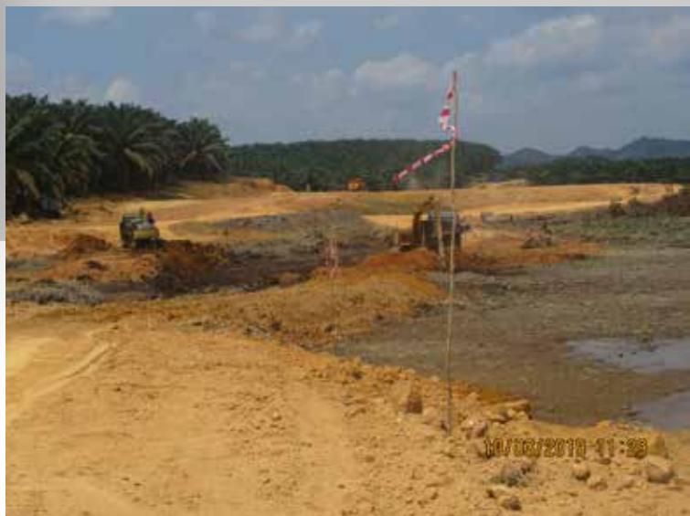
Gambar 3.12 : Tiada penyediaan sebarang BMPs semasa kerja-kerja pembukaan tanah di Kota Tinggi, Johor
