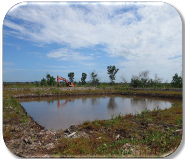
Rajah 47: Infrastruktur Kolam Takungan
