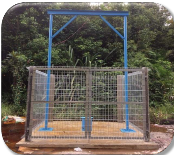
Rajah 49: Infrastruktur Telaga Tiub
