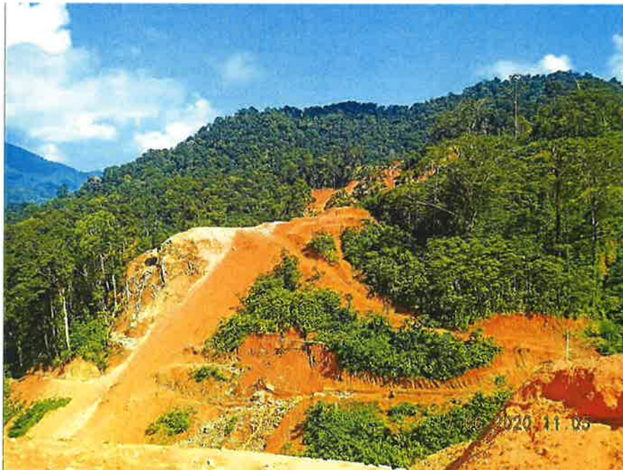
Gambar 16: Tiada penstabilan cerun dilaksanakan, semua cerun potong (cut slope) tidak mengikut standard dan semua cerun tambak (fill slope) tidak dibuat mengikut kaedah yang betul.
