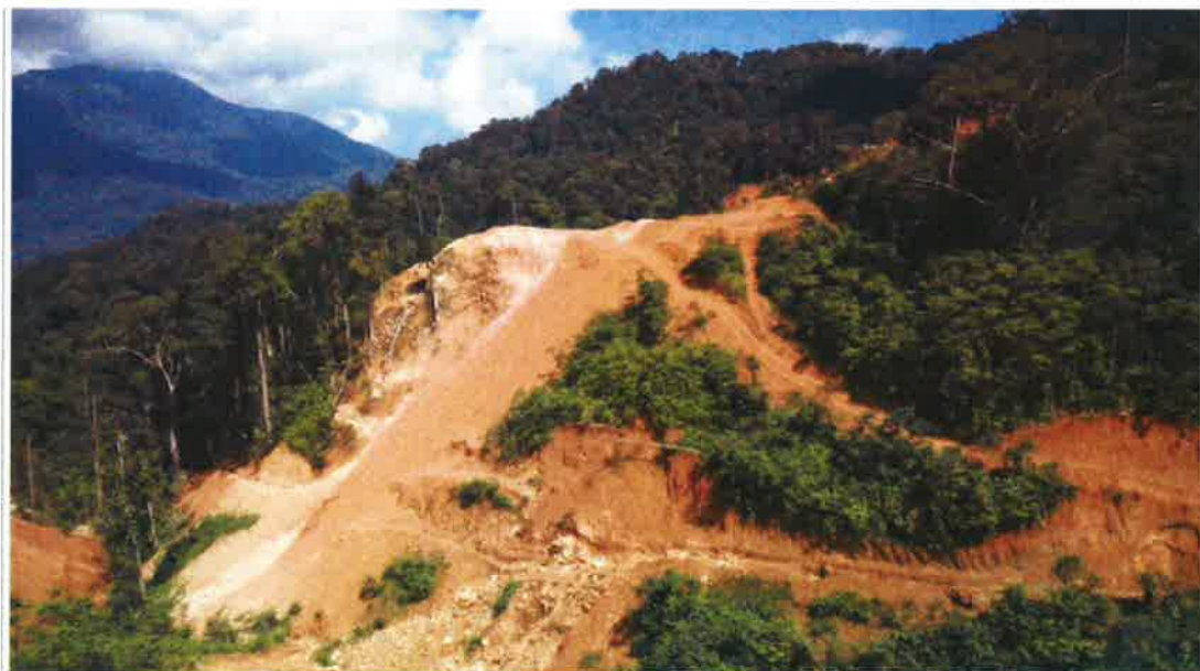
Gambar 18: Sebuah bukit yang dalam tapak projek telah digondolkan tanpa sebarang langkah kawalan hakisan dan kelodakan
