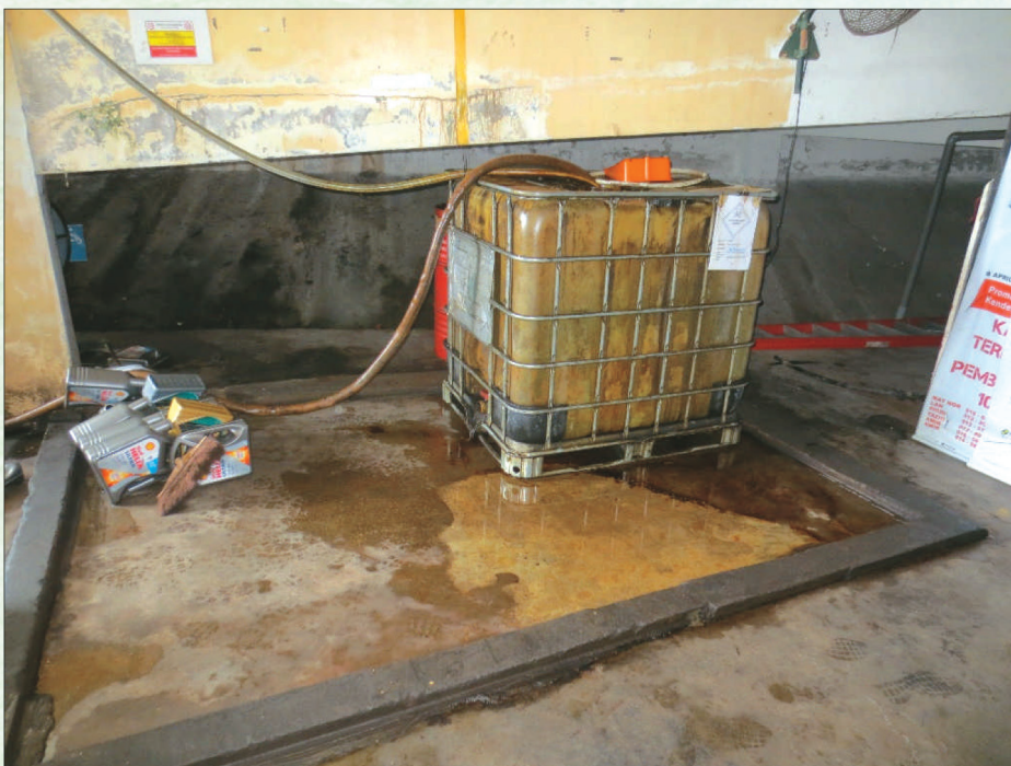
Foto 3.5: Kawasan penstoran buangan terjadual yang tidak diselenggara dengan baik
