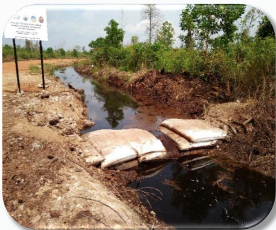
Rajah 46: Infrastruktur Check dam .
