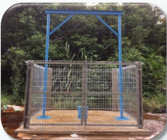
Rajah 48: Infrastruktur Telaga Tiub.
