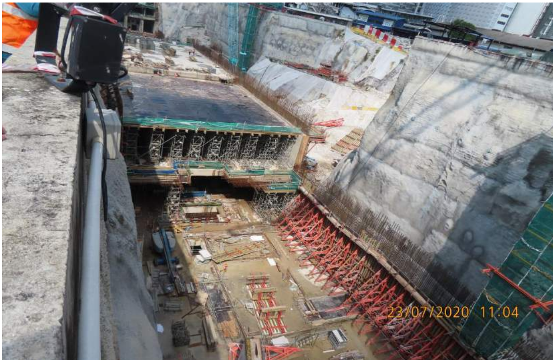
Foto 17 : Pemeriksaan permukaan cerun bagi pembinaan stesen MRT di bawah permukaan tanah yang telah distabilkan menggunakan cement grouting
