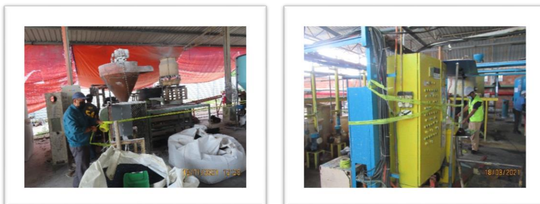
Gambar 9.3: Alat kawalan pencemaran udara tidak diselenggara dan menghasilkan pelepasan yang berbau dan berhabuk
