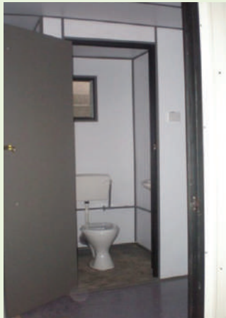
i. Site Cabin Toilet
