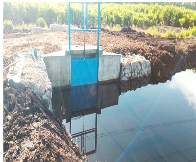
Sekatan Saliran (Check Dam) di Selangor
