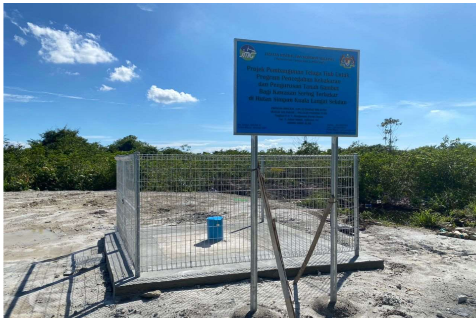
Foto 4.17: Tube well yang dibina di kawasan fire prone di Negeri Selangor
