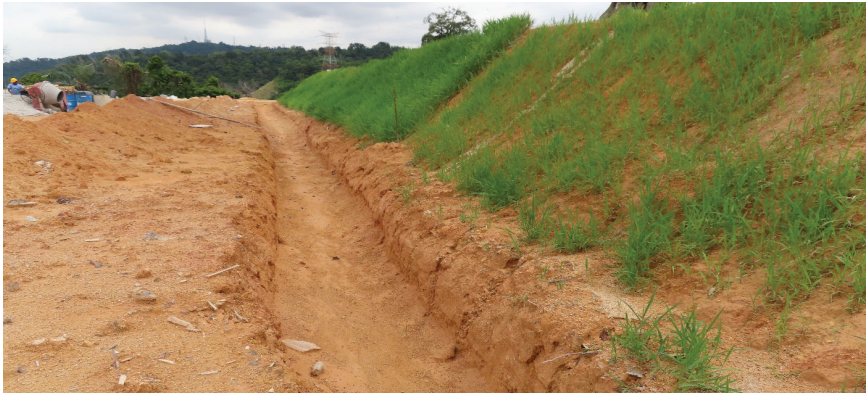
Gambar 2.19: Pemeriksaan earth drain projek UPMN.
