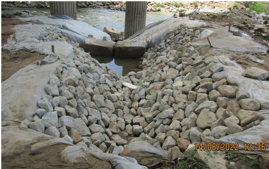
Gambar 2.17: Silt trap yang terdapat di Section 1 projek SPE.
