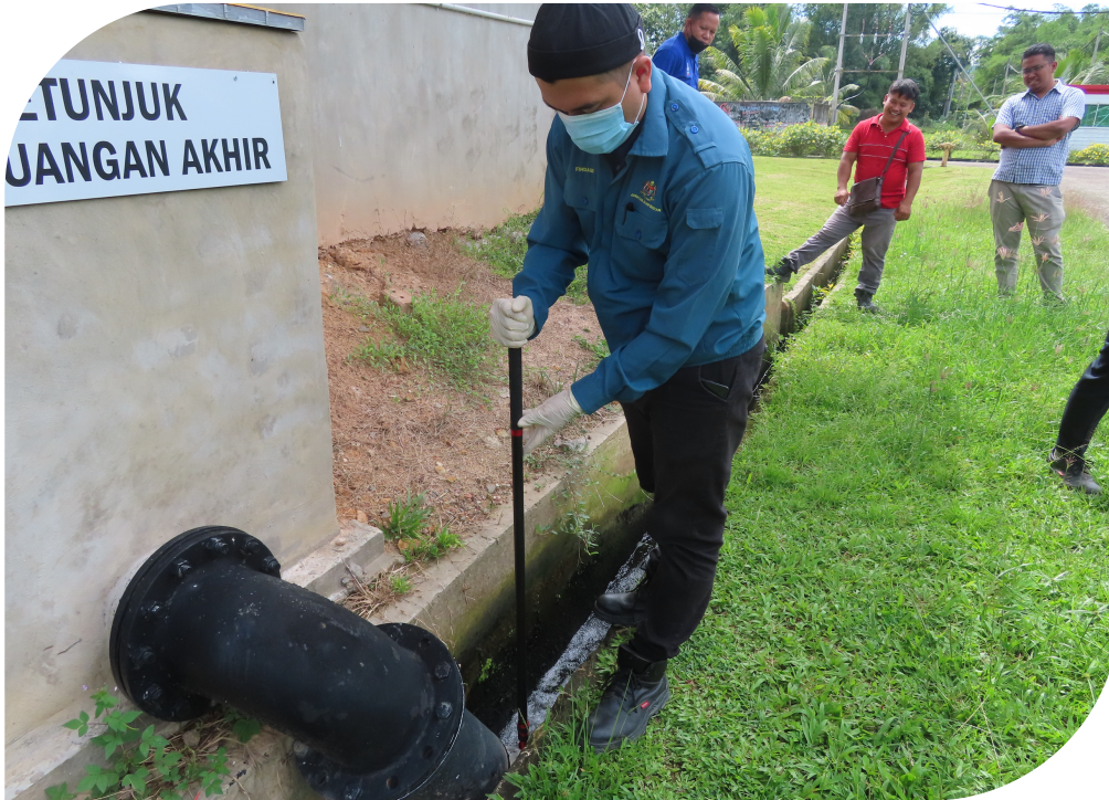
Gambarajah 9.1: Kerja-Kerja Persampelan Rasmi Air Efluen Kumbahan Premis EIA.
