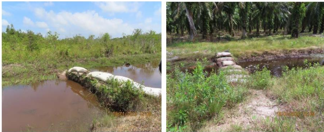
Gambar 9.16: Check Dam di salah satu lokasi di kawasan operasi Cawangan Kluang
