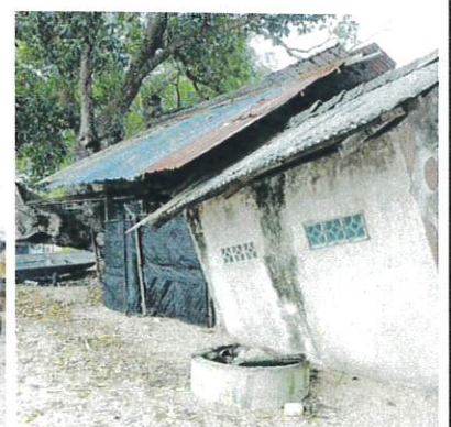
ANTARA struktur yang hampir rebah akibat hakisan.
