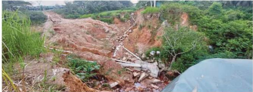
KEADAAN cerun dan runtuhan tanah yang membimbangkan penduduk di sekitar Taman Lipat Kajang, Jasin, Melaka.
