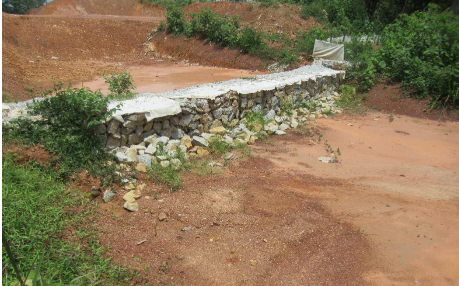
Rajah 2.14: Pembinaan rock gabion yang betul menghalang kelodakan memasuki aliran air awam
