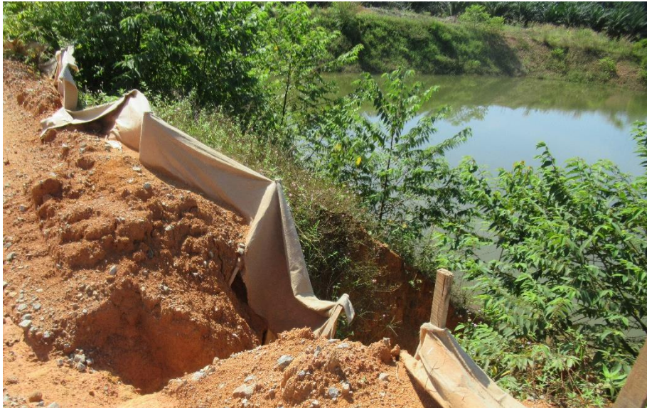
Rajah 2.16: Silt fence yang telah tumbang tetapi tidak diselenggara dengan serta merta
