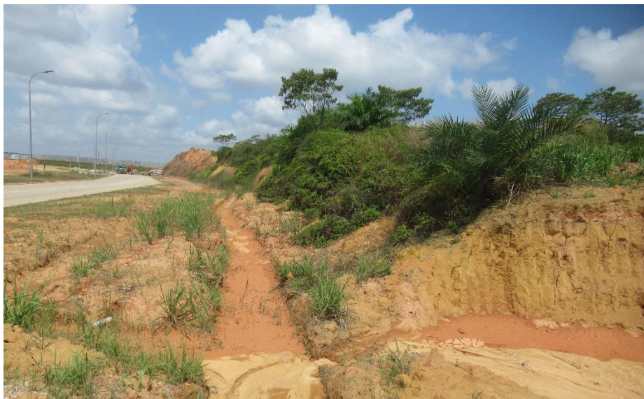
Rajah 2.19: Earth drain tidak dijalankan penyelenggaraan
