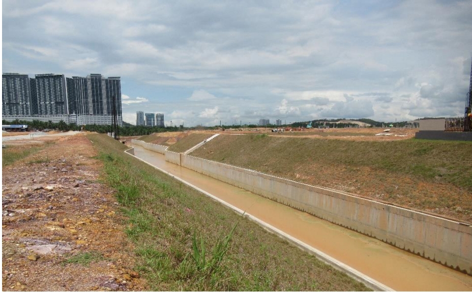
Rajah 2.10: Tebing yang telah dijalankan turfing dan concrete drain yang menghalang hakisan
