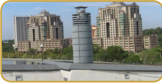
Gambarfoto 3.13 : Pemasangan Cerobong Daripada Pengahar, Alat Kawalan Pencemaran Udara di Premis Institut Pengajian Tinggi (IPT)
