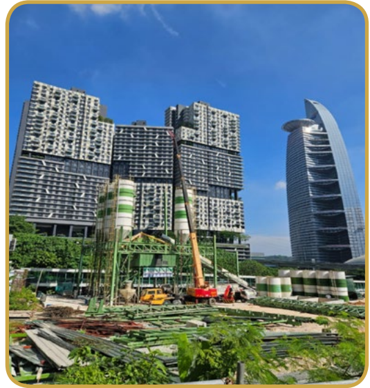
Gambarfoto 3.1 : Salah Satu Batching Plant Yang Terdapat di Sekitar Ibu Negara Kuala Lumpur
