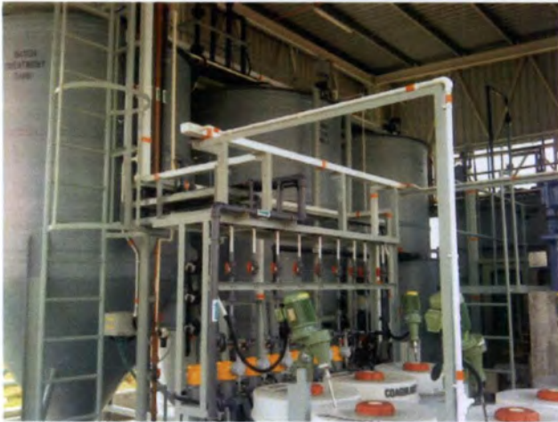
Plat 3.4 Johor : Sistem Pengolahan Effluen Yang Mematuhi Syarat-Syarat Sijil Kelulusan Dan Telah Beroperasi
