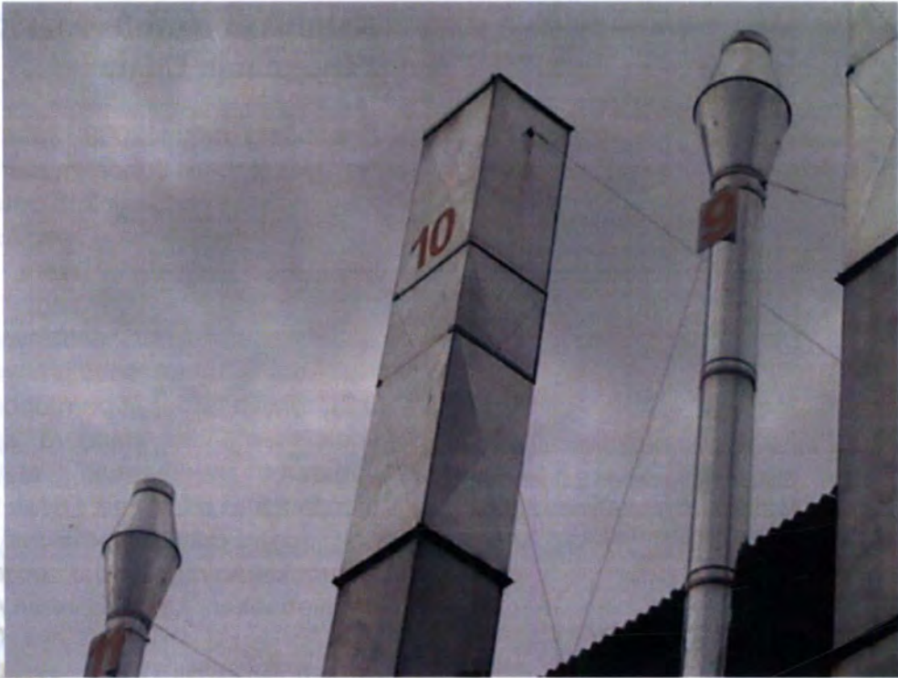
Plat 3.6 Johor : Cerobong Yang Dilengkapi Rain Cap
