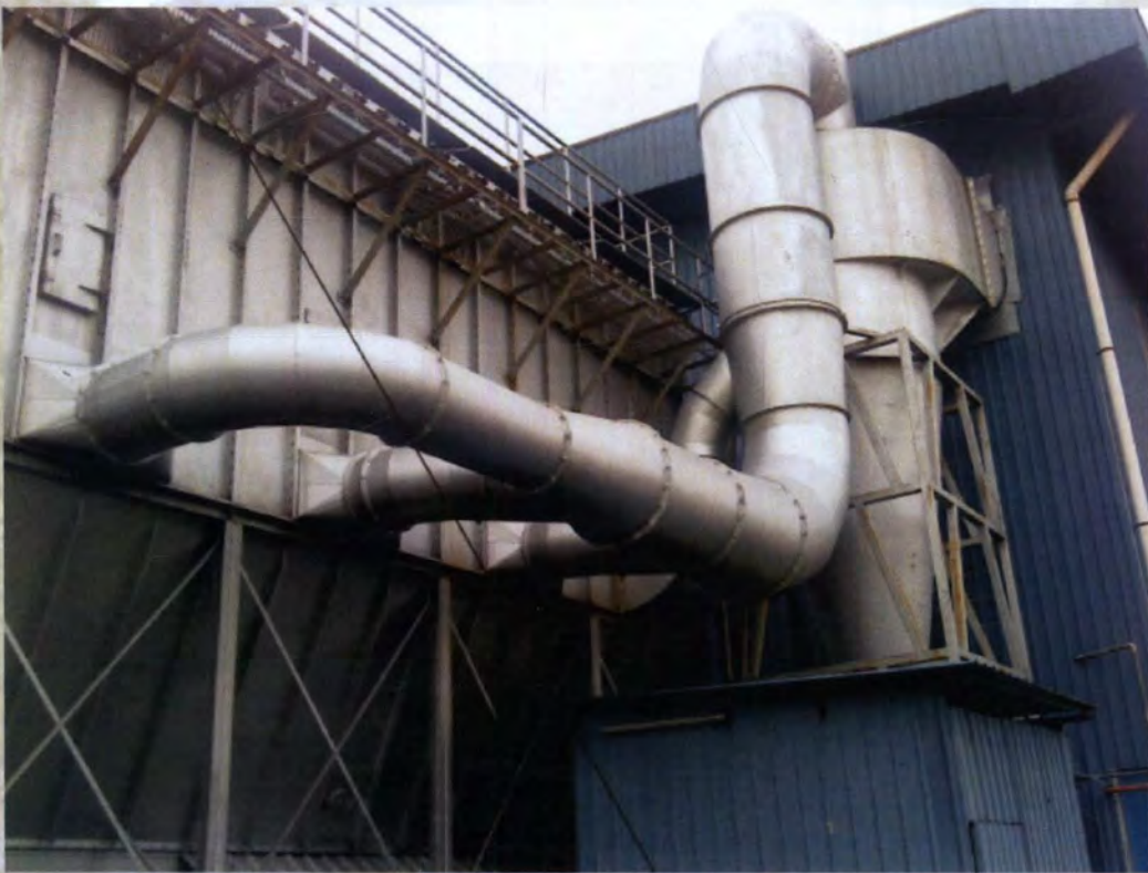
Plat 3.5 Johor : Cyclone Dust Collector Yang Dipasang Sebelum Bag Filter Dust Collector
