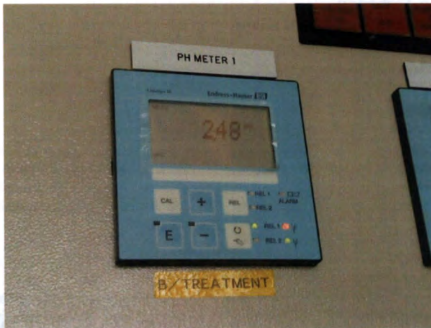
Plat 4.2 Johor : Salah Sebuah Alat Yang Dipasang Pada Sistem Loji Pengolahan Effluen Bagi Tujuan Performance Monitoring
