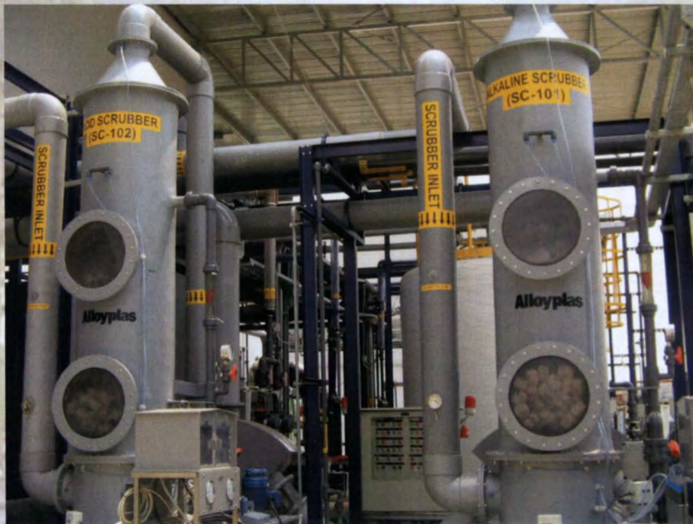
Plat 3.7 Johor : Penggahar (Scrubber) Yang Dilengkapi Alat Pemantauan Prestasi
