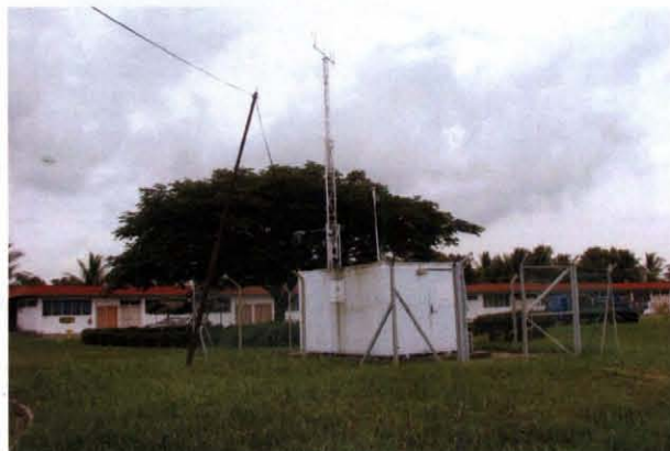
Gambar 2.3 : Stesen Pengawasan Udara Di Pejabat JKR, Sandakan
