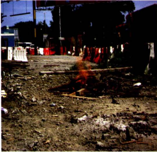
Rajah 4.22 : Pembakaran Terbuka Tapak Pembinaan
