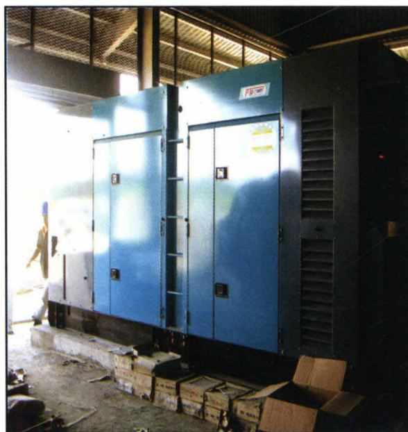
Gambar 3.13: Janakuasa yang baru dipasang
