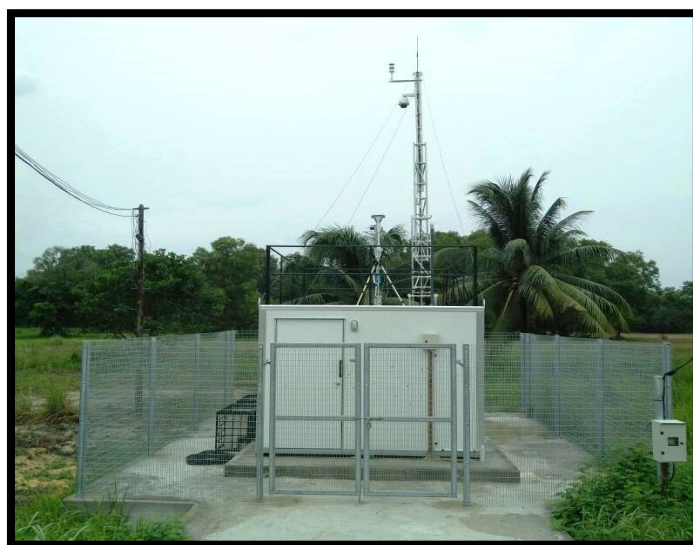
Stesen udara di Balok Baru, Kuantan
