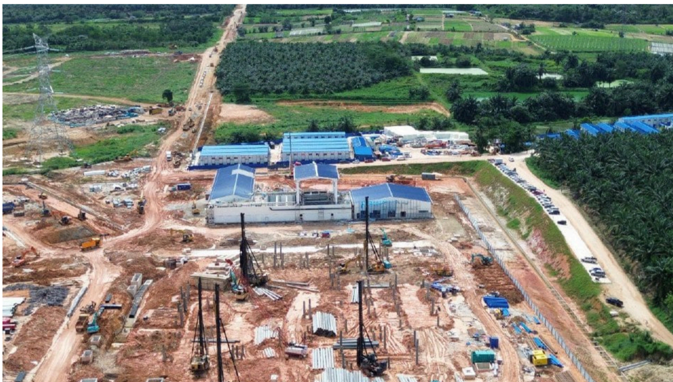
Sebahagian daripada lebih 20 hektar kawasan perindustrian yang dibangunkan sebuah syarikat tanpa mendapat Kelulusan Laporan Penilaian Kesan Kepada Sekeliling (EIA). - Foto IHSAN JAS
