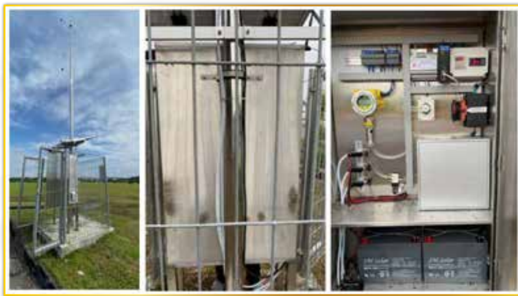
Rajah 6 : Stesen Pengawasan Gas Toksik Total Volatile Organic Compounds (TVOC)
