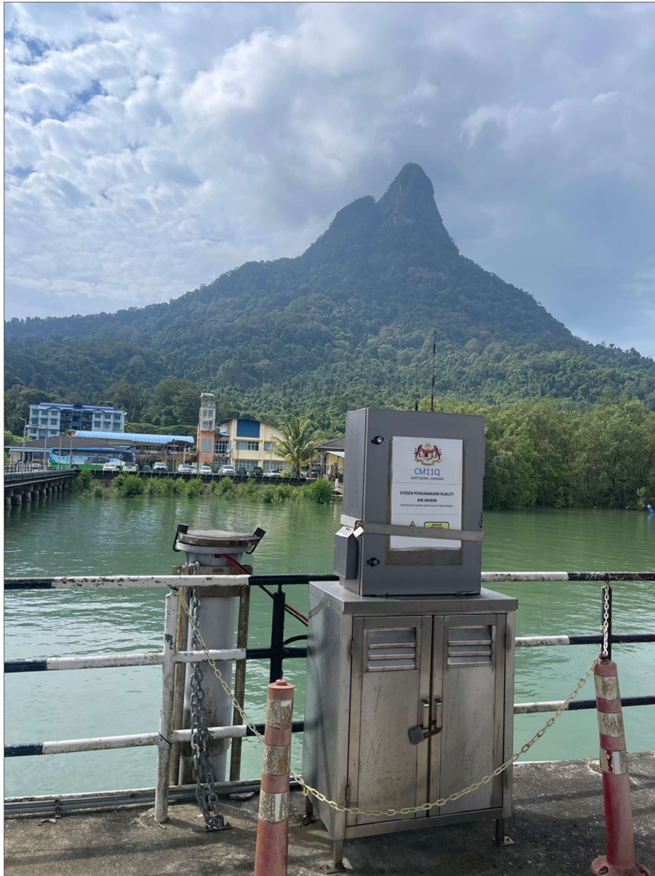
Foto 4.8: Stesen pengawasan kualiti air marin automatik (CMWQM) yang terletak di kuala Sungai Santubong, Kuching
