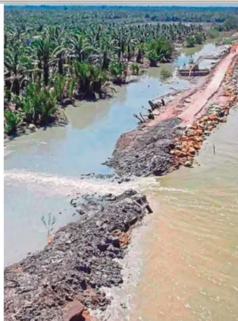
Benteng penahan ombak di Kampung Sungai Berong Laut pecah menyebabkan beberapa rumah penduduk ditenggelami air laut.
